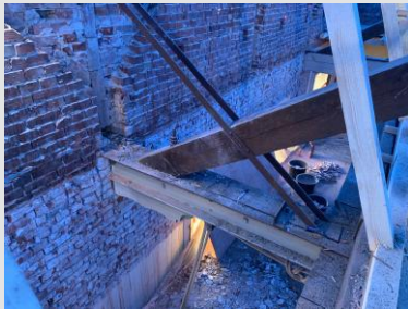
Turnhalle - Schadensbild Dachstuhl
